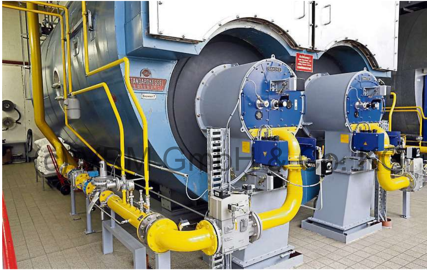
Auf dem Lerchenberg wird eine Fernwärme-Anlage eingesetzt. Die Mainzer Wärme Plus hat im vergangenen Jahr die Verträge geändert – darüber wurde im Ortsbeirat diskutiert.
